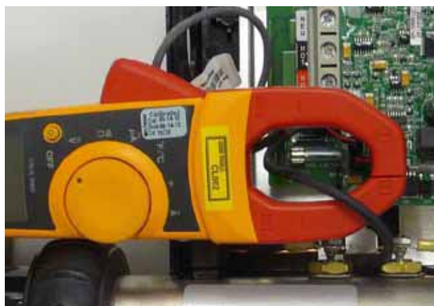
VERIFICA DELL'AMPERAGGIO NEL RISCALDATORE BP600
