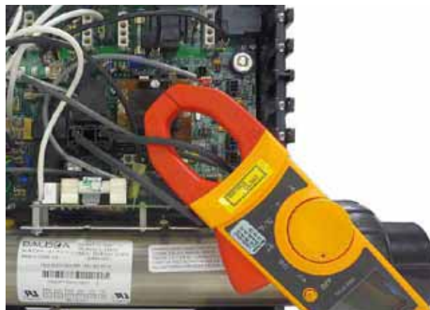
VERIFICA DELL'AMPERAGGIO NEL RISCALDATORE BP2100G1
