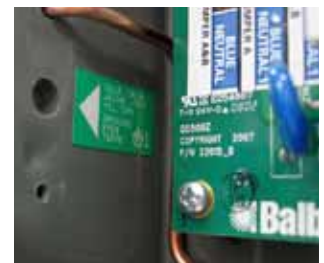
Morsetto di Terra nella Cassetta di Comando
