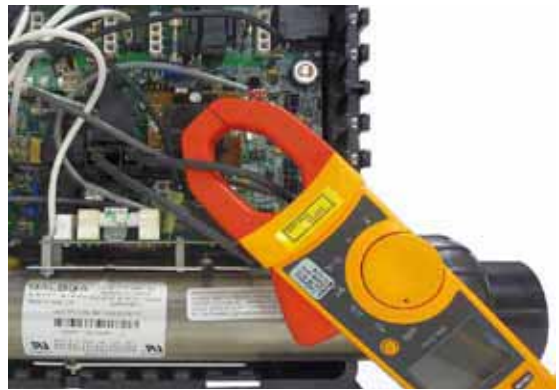
DURANTE LA MISURAZIONE DELL'AMPERAGGIO
